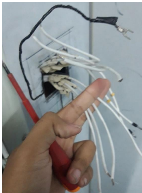
Gambar 1. Ujung Kabel pada Ruang Komandan
